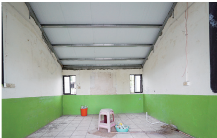
●台風の被害を受けて家具は散乱しているが柱はまだ丈夫だ。慈済が修繕した白い天井と屋根。いつ風雨が襲っても怖くない。
